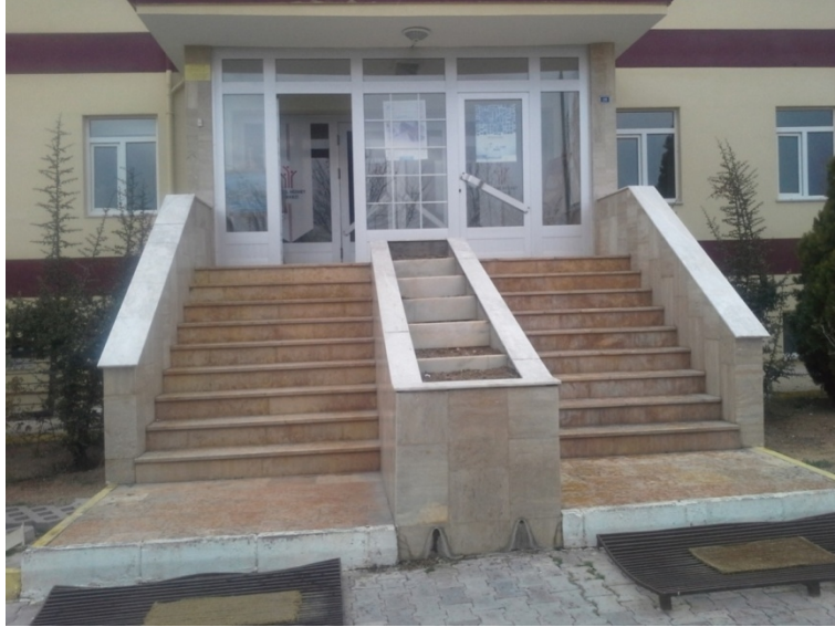
Fotoğraf 17. Kamuya ait bir binanın giriş merdivenleri (Olumsuz Örnek)
