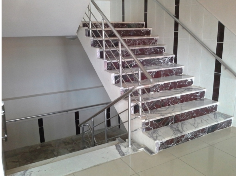
Fotoğraf 16. Kamuya ait bir binanın merdivenleri (Olumsuz Örnek)
