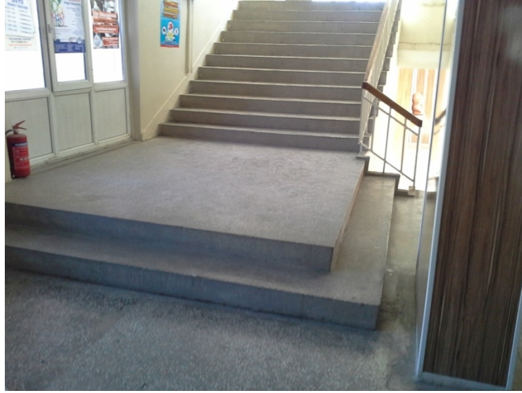
Fotoğraf 4. Görme engellilere uygun olmayan merdiven (Olumsuz Örnek)
