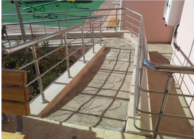
Fotoğraf 5. Rampa zemini uygun değil. (Olumsuz Örnek)
