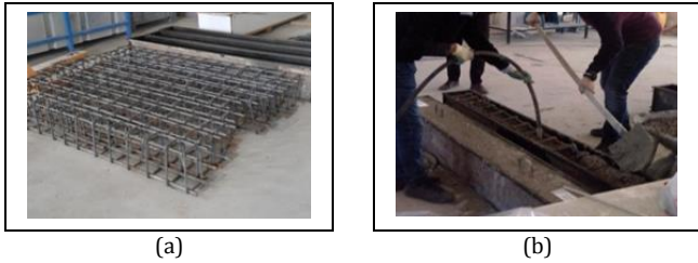
Şekil 3. Büyük ölçekli betonarme kiriş numuneleri hazırlanması. (a): donatı teşkili, (b): Beton dökümü.
